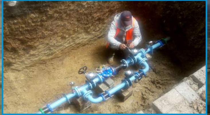
13 válvulas reguladoras de presión
